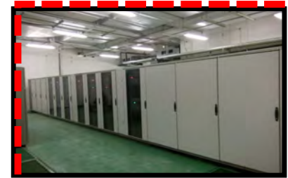
400V MSB. Plisma, Type Test Schneider. SuperMega
